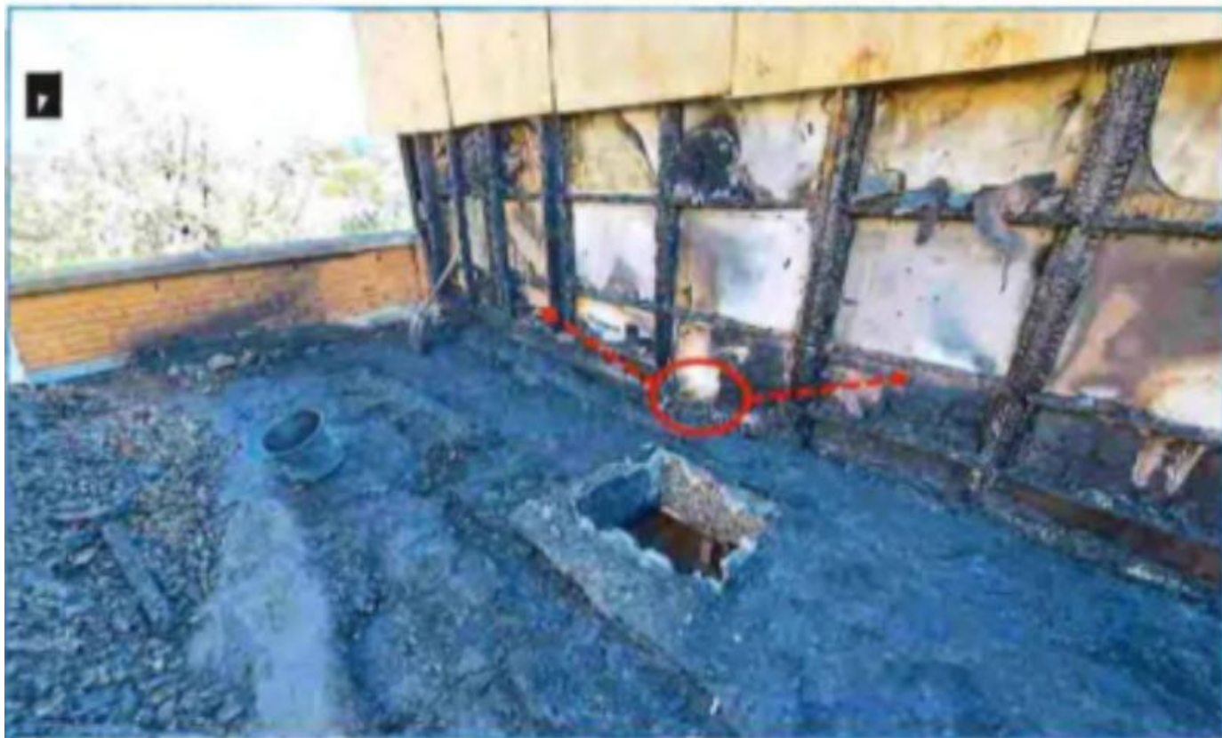
Figuur 4 Ontstaansgebied (cirkel) en branduitbreiding in V-vorm
